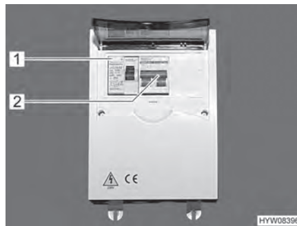
Fig. 116 Scatola dei fusibili a 230 V con interruttore di sicurezza e interruttore automatico FI
