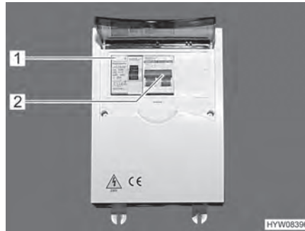
Kuva 116 230 V:n sulakerasia ja johdinsuojajytkin sekä FI-kytkin
